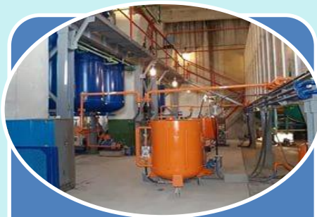
ООО «ДЭКО» – производство краски
